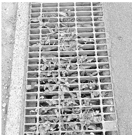
清掃が待たれる側溝
