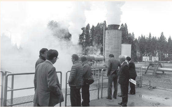
上の岱地熱発電所
