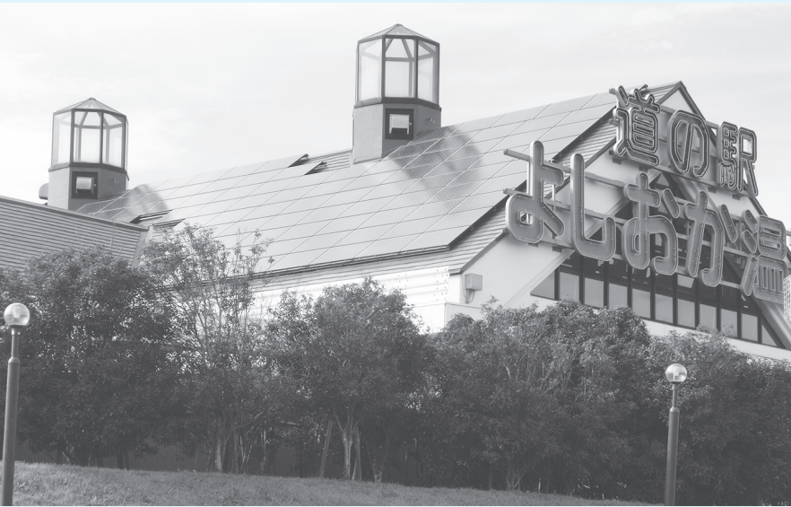
よしおか温泉棟の屋根に並べられている「太陽光発電パネル」
