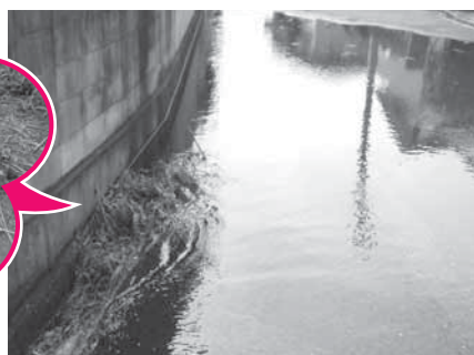
水路が詰まり、道路に水があふれている
