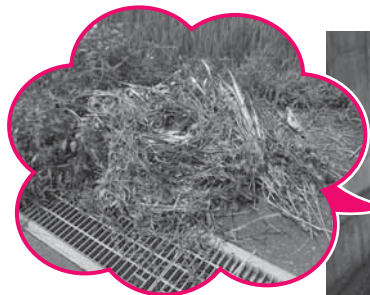
水路に詰まっていた草やごみ
