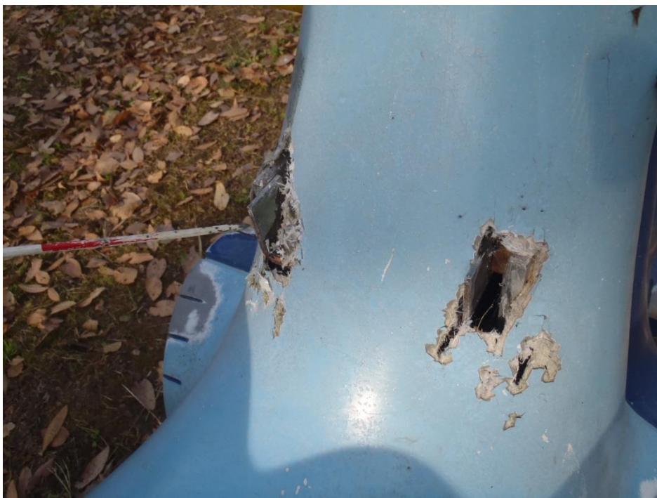
図10 破損部位（支柱の老朽化・金具の露出）
