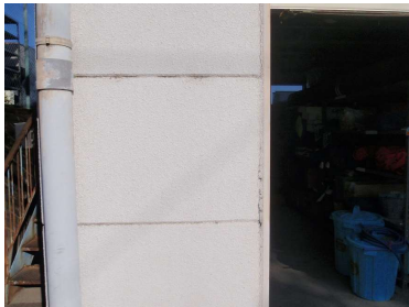
シールの劣化
