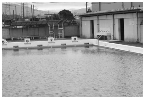
老朽化が著しい町民プール
