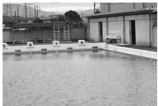
老朽化が著しい町民プール
