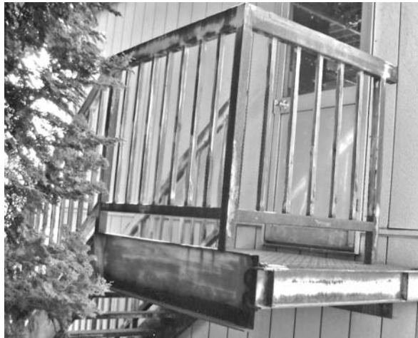
補修が待たれる町民グラウンド倉庫階段
