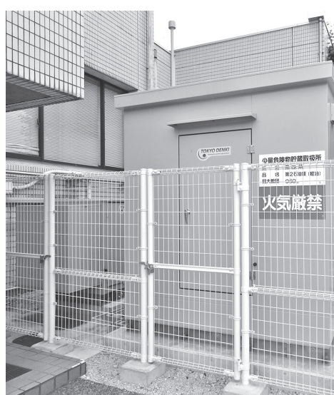
いざという時の心強い味方（役場庁舎非常用発電機）
