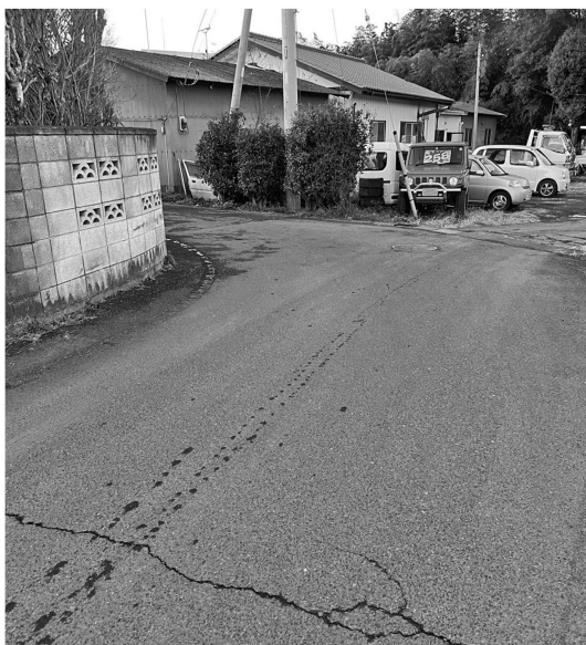
狭くて危険（役場南の町道）
