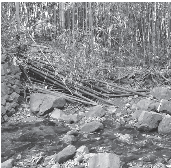
越水の恐れある、竹林の地下茎と石が支える護岸
