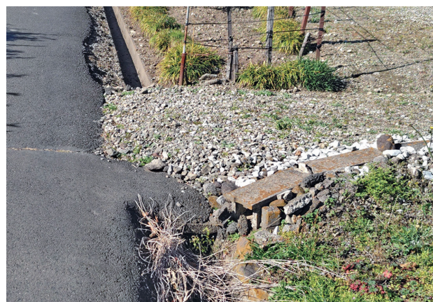
改修が決まった側溝
