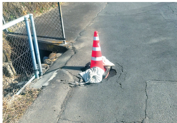
道路陥没について点検の必要性がある
