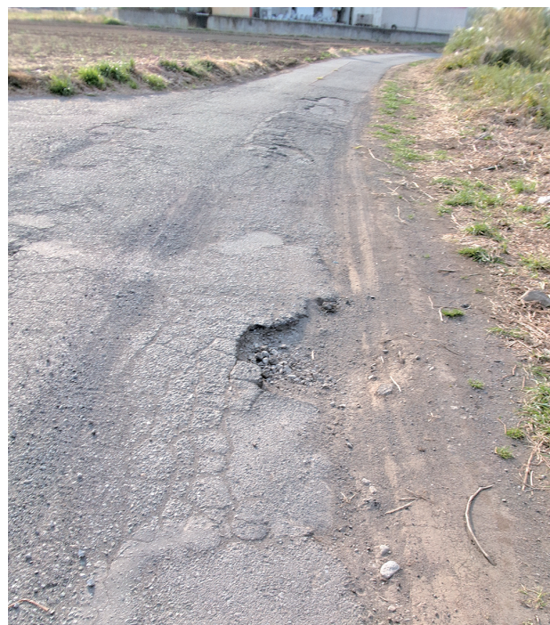
計画的補修を待つ町道
